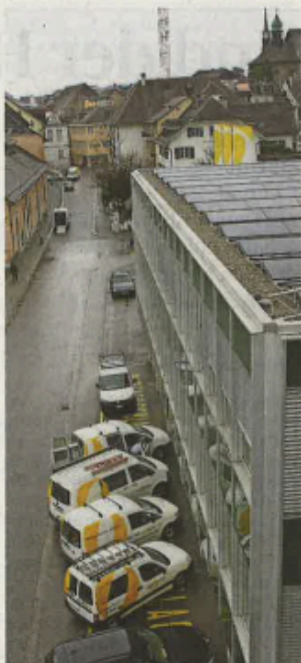
Auch die Energieversorger selber setzen auf «Erneuerbare»: Photovoltaikanlage auf dem Dach der Regio Energie in Solothurn.
